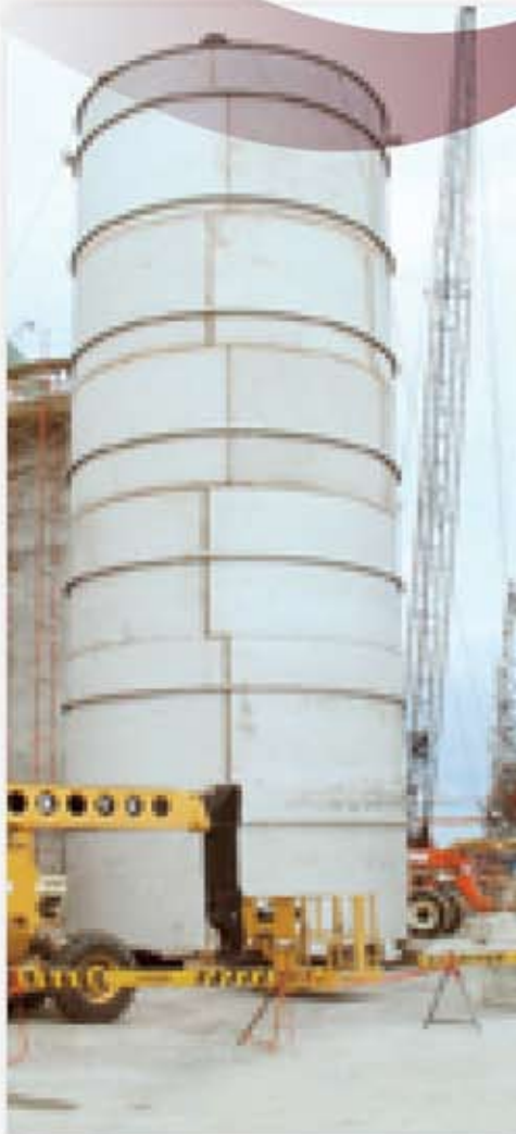
Réservoir • Québec, Canada
