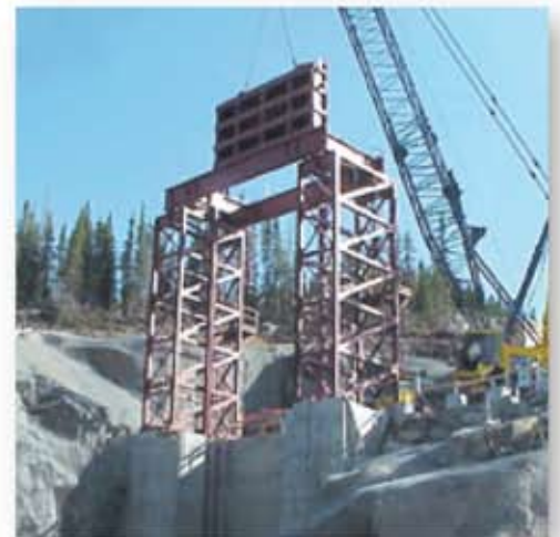
Vannes de barrage • Québec, Canada
