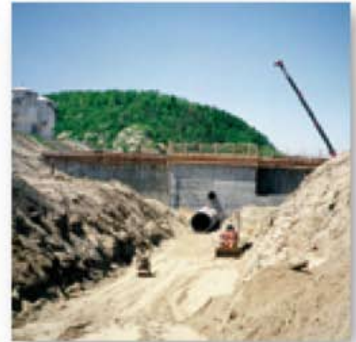
Tuyauterie souterraine • Québec, Canada
